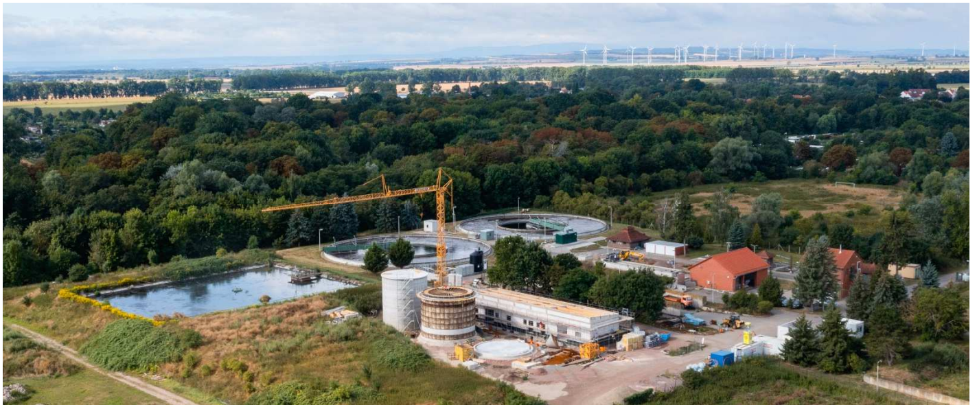
Foto.: Luftbild der Kläranlage Oschersleben – Sicht auf Klärschlammfaulungskomplex August 2021 (Foto: © TAV Börde)
